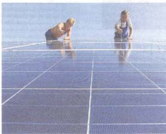
Dagli 84.574 impianti fotovoltaici entrati in funzione nel 2010 si è passati ai 147.776 del 2011, con un aumento che va oltre il 74%
